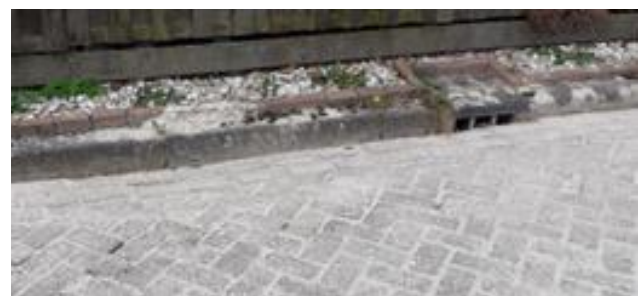
straatniveau te hoog bij de put en te laag er direct naast resultaat grote diepe plassen.
